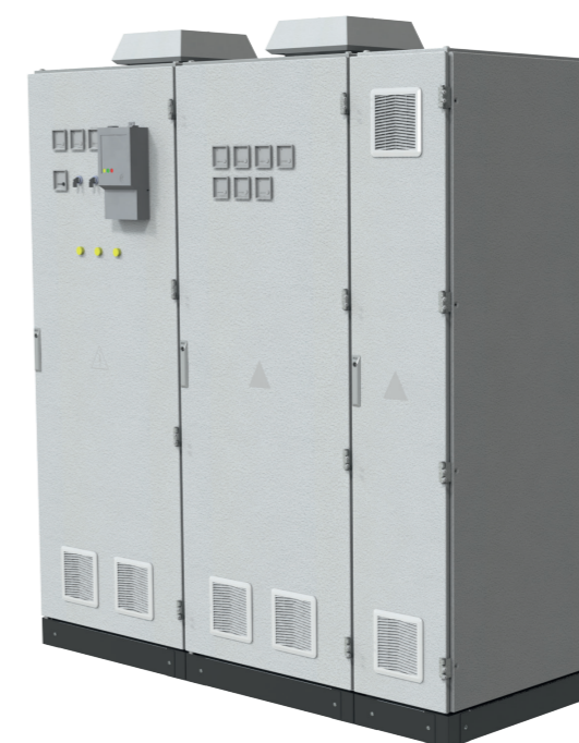
Общий вид секции НКУ с оборудованием на дверях
