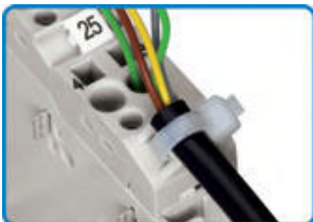
Закрепление кабеля на разъеме
